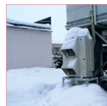
Пример эксплуатации наружного блока
